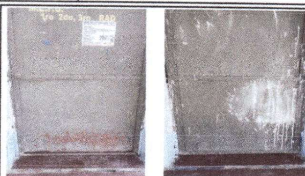
Foto 2: Puertas de Metal de las aulas, deterioradas con manchas y oxido.
