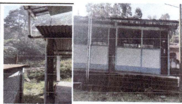
Foto 4: Canales bandeados, rebalsa el agua y bajadas de agua con hoyos.
