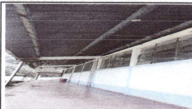
Foto 3: Ventanas de metal deterioradas y vidrios opacos, quebrados por antigüedad
